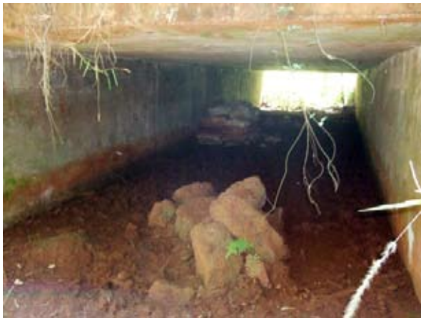
Pasafauna por debajo de la Ruta Provincial N° 19, dentro del Parque Provincial urugua-í, si bien se encuentra parcialmente obstruido con bolsas de cemento que quedaron desde su construcción, el Tapir los utiliza. Foto: Gentileza Julio Stang.
